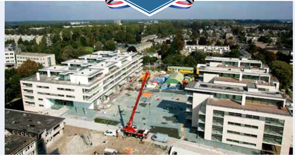
Foto 18. Bouw van de Urban villa's en de Loft appartementen in september 2008 Bron: fotocollectie Idsard Bosman
